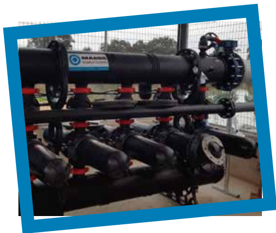
Bateria de filtros na empresa, Bosques Alegres Amendoal Intensivo, 149 ha
